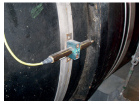
Jede Steckmuffe wird mit Sensoren überwacht
