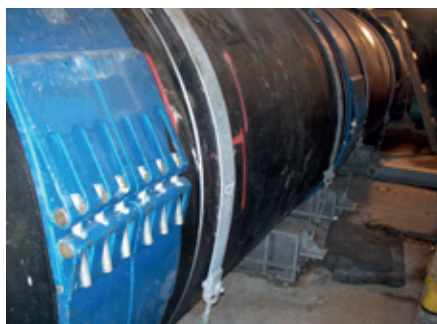
Eingesetzt wurde ein 2-teiliges Gehäuse, welches eine nachträgliche Montage ohne Bewegungen der Rohre ermöglichte
