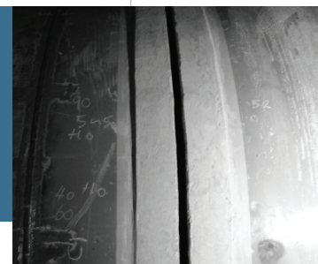
Für den Rohrenden-Aufbau wurden 1230 kg Sikadur 30, 20 kg Sikafloor 156 (Primer) und 20 kg Sikagard 63N (Coating) verwendet.
